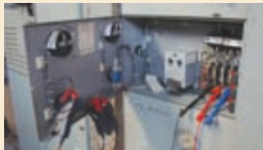
Mesures électriques à l'aide d'un moniteur portable Schneider Electric de modèle CM4000.
